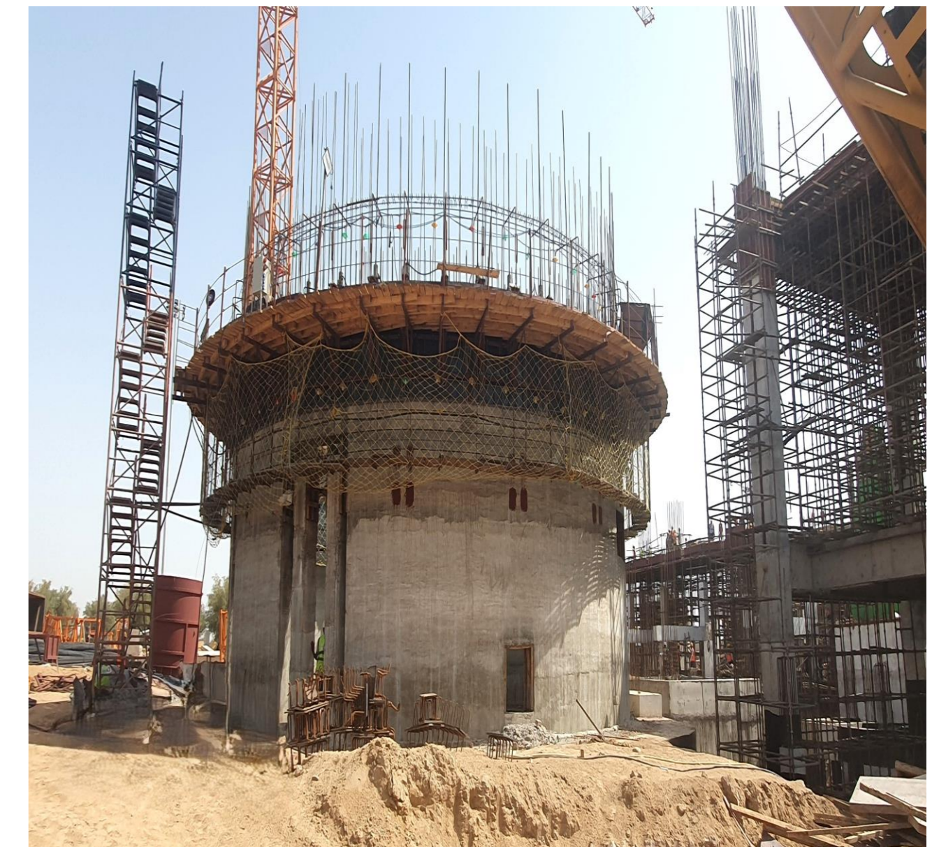
Fly Ash Silo
